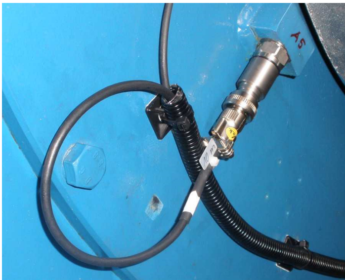
Sensor an Messstelle A5 installiert und verkabelt.
