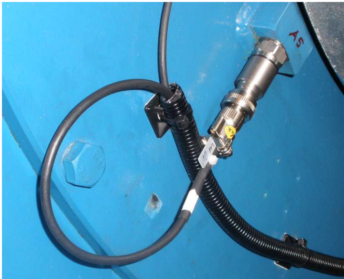
Sensor an Messstelle A5 installiert und verkabelt.
