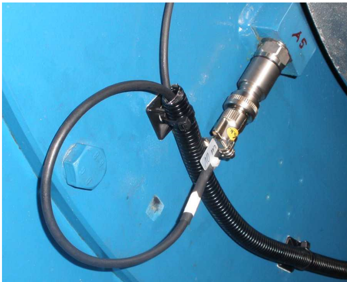
Sensor instalado y cableado en el punto de medición A5.
