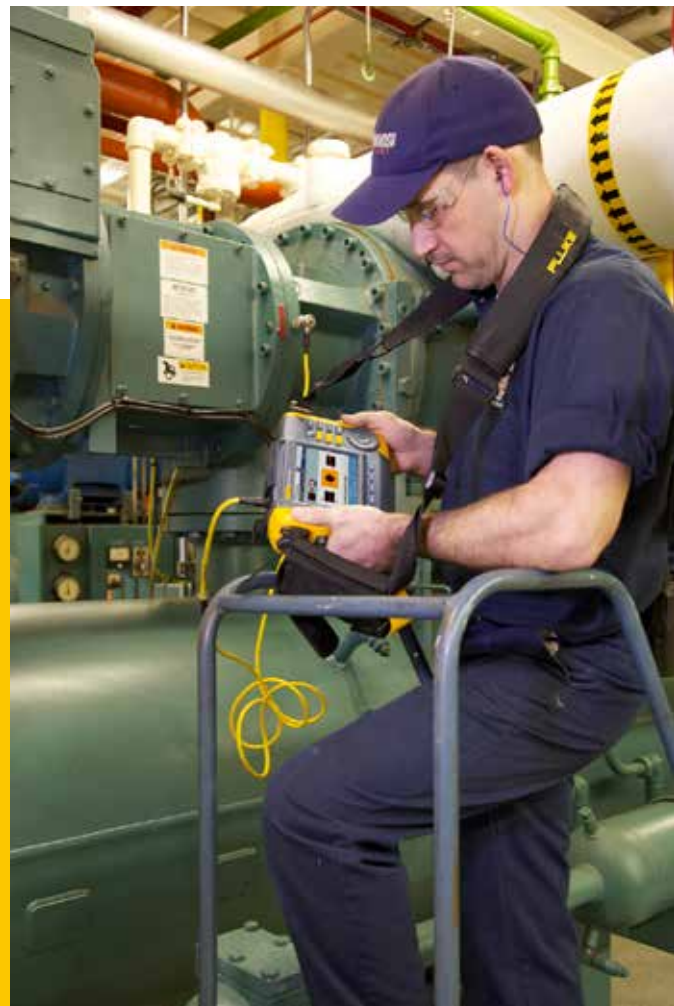
L'analyse des vibrations régulière à la laiterie Alpenrose fournit des données pour l'analyse des tendances utilisée en maintenance préventive.
